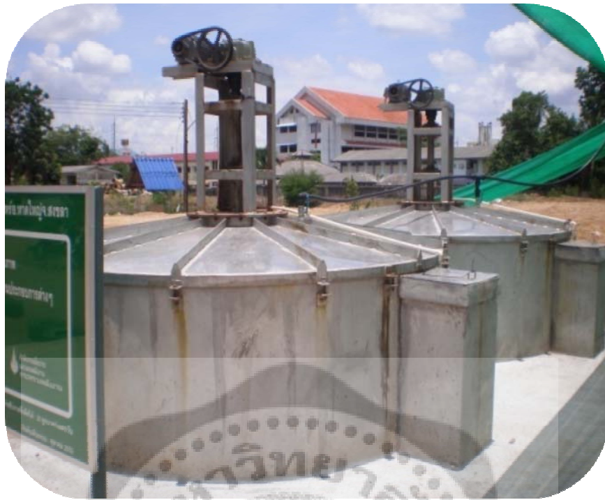
ภาพถ่ายสถานที่จริง
