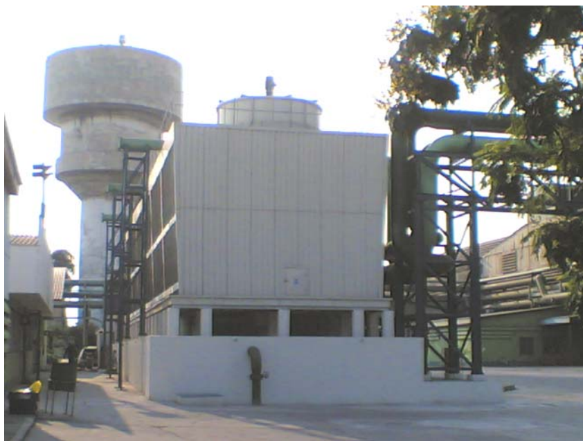
ภาพประกอบ 10 หอทำความเย็นแบบน้ำและอากาศสัมผัสโดยตรง (ระบบเปิด)
