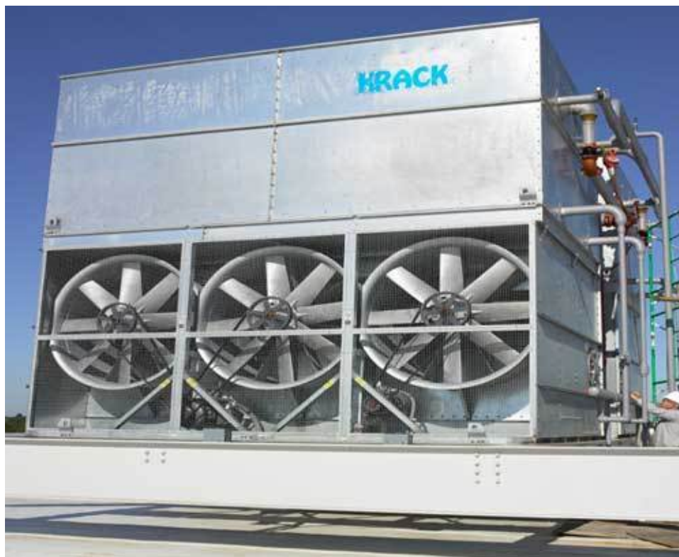
ภาพประกอบ 2.9 หอทำความเย็นแบบพัดลมเป่า
