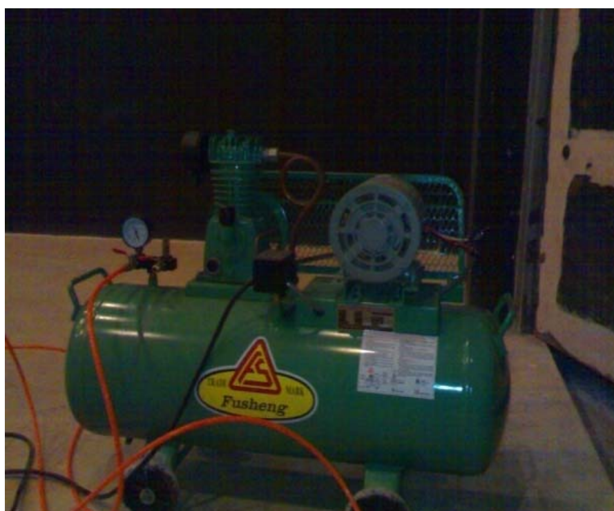
ภาพประกอบ 28 ถังลมพร้อมอุปกรณ์อัดลม
