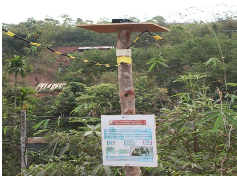
ภาพประกอบ 24 การติดตั้งหัววัดความเข้มแสงไว้นอกอาคารเพื่อให้ได้รับแสงอาทิตย์ตลอดทั้งวัน
