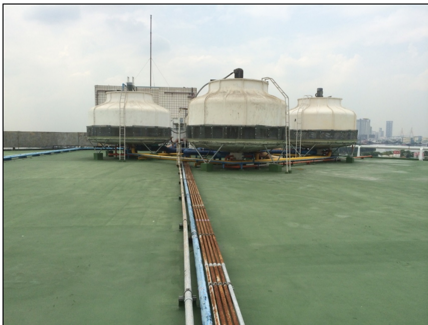
ภาพประกอบ 46 พื้นที่ติดตั้งหอทำความเย็นบนชั้นดาดฟ้าอาคารเซลล์เฮาส์
