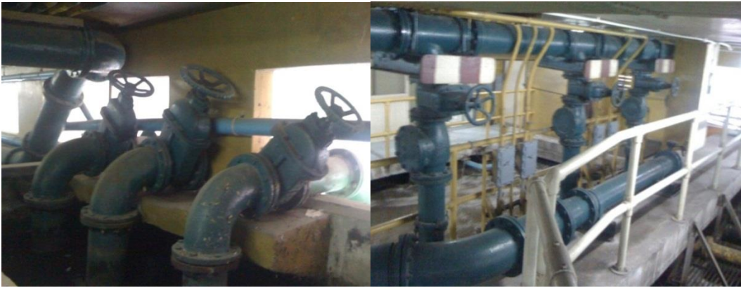
ภาพประกอบ 1 ระบบดูตน้ำเสียลงบ่อพักเพื่อรอการบำบัด
