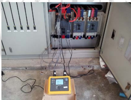
ภาพประกอบ 24 เครื่องบันทึกค่าพลังงานไฟฟ้า 3 เฟสขณะทำการบันทึกค่าพลังงาน
