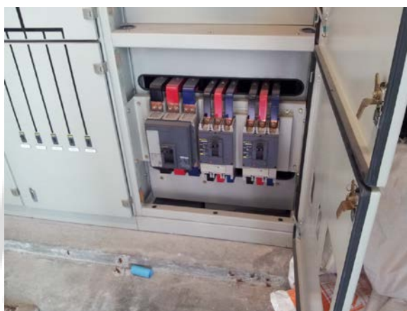
ภาพประกอบ 21 เบรกเกอร์ของเครื่องทำน้ำเย็น
