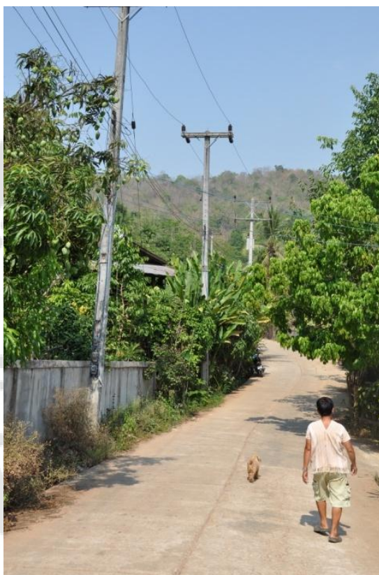
ภาพประกอบ 9 ระบบไฟฟ้าในหมู่บ้าน
