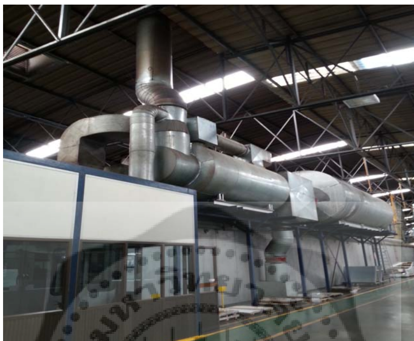
ภาพประกอบ 18 ปล่องความร้อนเหลือทิ้งจากเครื่องเคลือบผิวกระป๋อง
