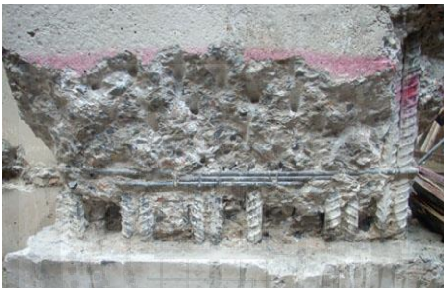
ภาพประกอบ 7 คอนกรีตเป็นโพรงเนื่องจากกระบวนการควบคุมคุณภาพไม่ทั่วถึง
