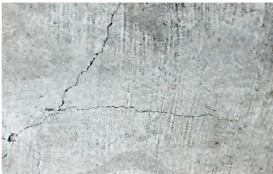
ภาพประกอบ 9 รอยแตกผิวหน้าจากการพัฒนากำลังคอนกรีตในสภาพที่มีอากาศร้อน
