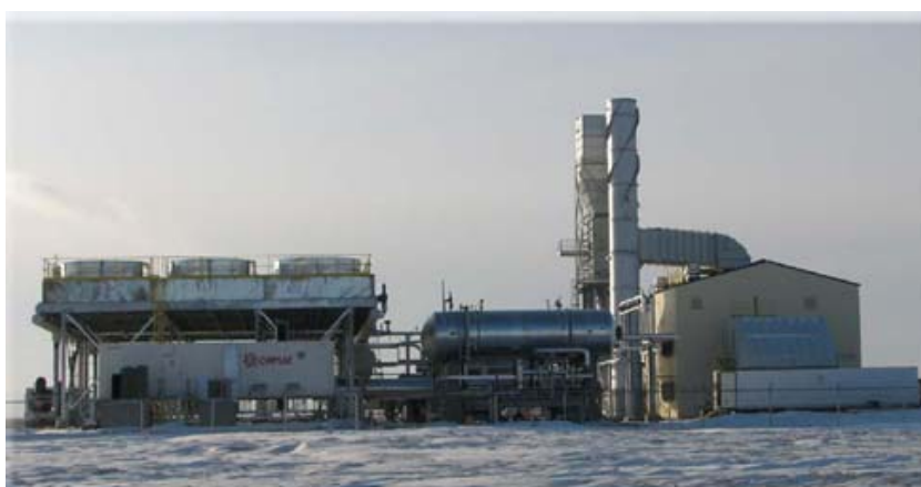
ภาพประกอบ 35 อุปกรณ์และเครื่องจักรของระบบ OGC
