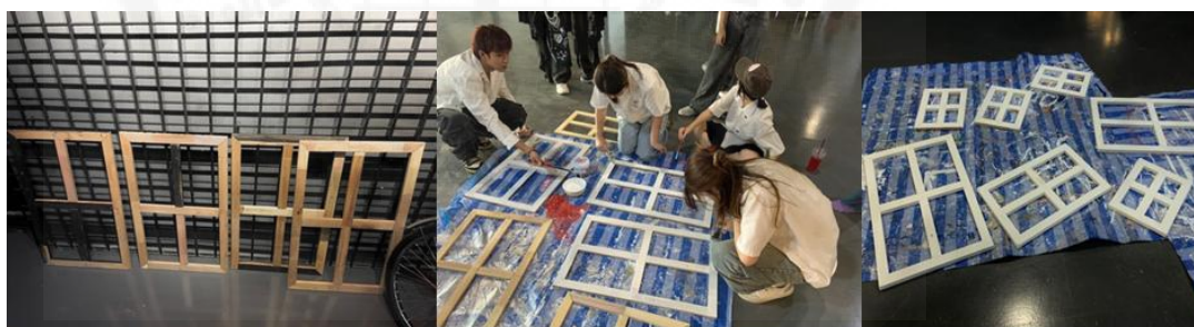
ภาพที่ 3.26: ภาพกระบวนการสร้างกรอบหน้าต่าง (2)
