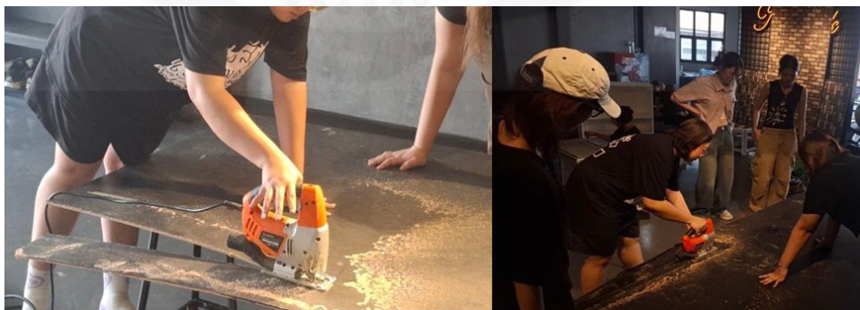
ภาพที่ 3.30: ภาพกระบวนการสร้างกรอบหน้าต่าง
