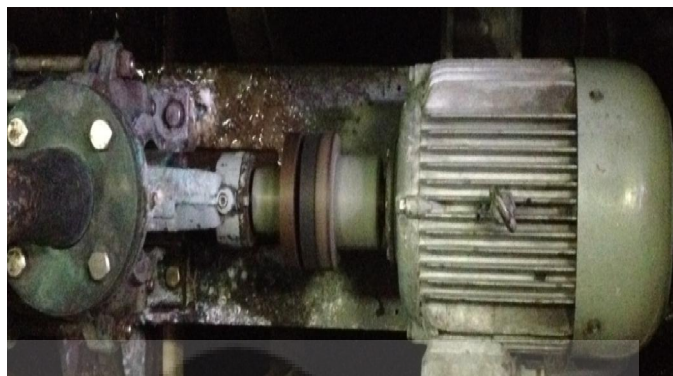
ภาพประกอบ 47 มอเตอร์น้ำทะเลหล่อเย็นเครื่องปรับอากาศ
