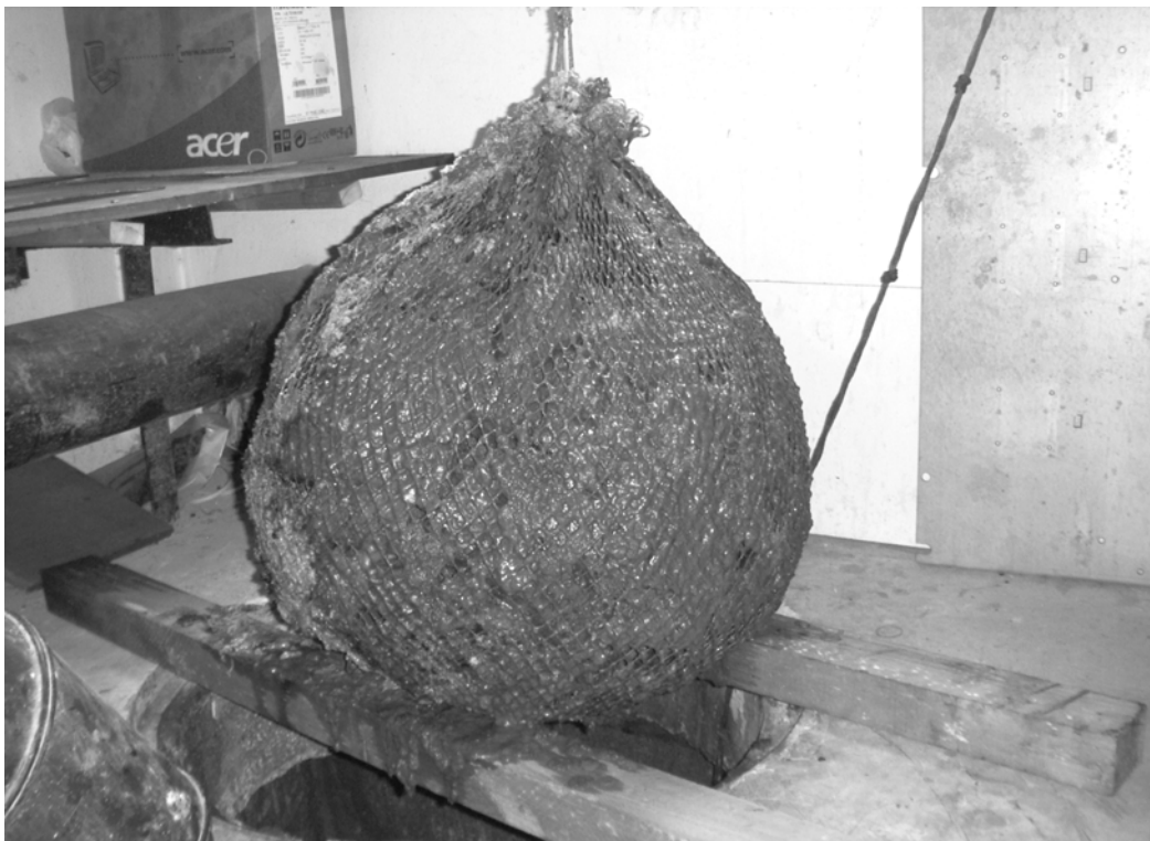
ภาพประกอบ 35 แสดงตะกอนภายในระบบบำบัดที่ส่งผลต่อประสิทธิภาพของระบบบำบัดน้ำเสีย
