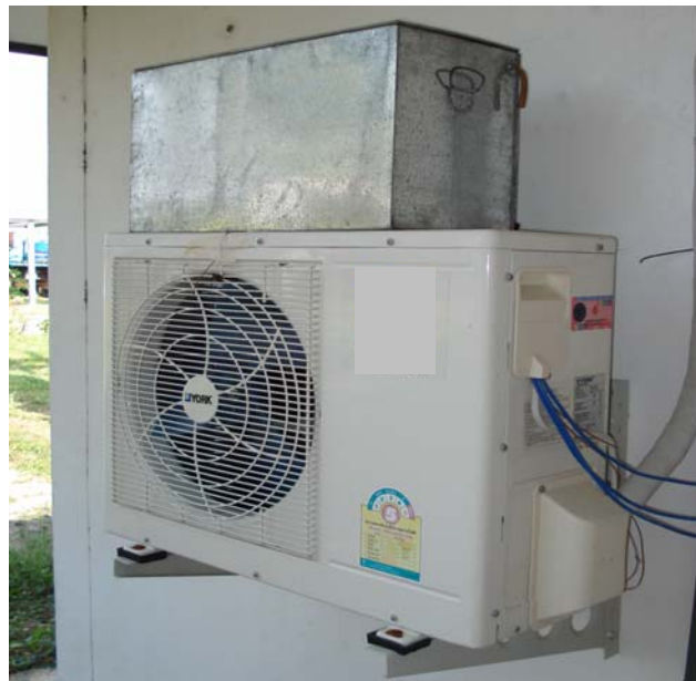
ภาพประกอบ 21 ถึงชุดท่อความร้อนวางด้านบนชุดคอนเดนเซอร์
