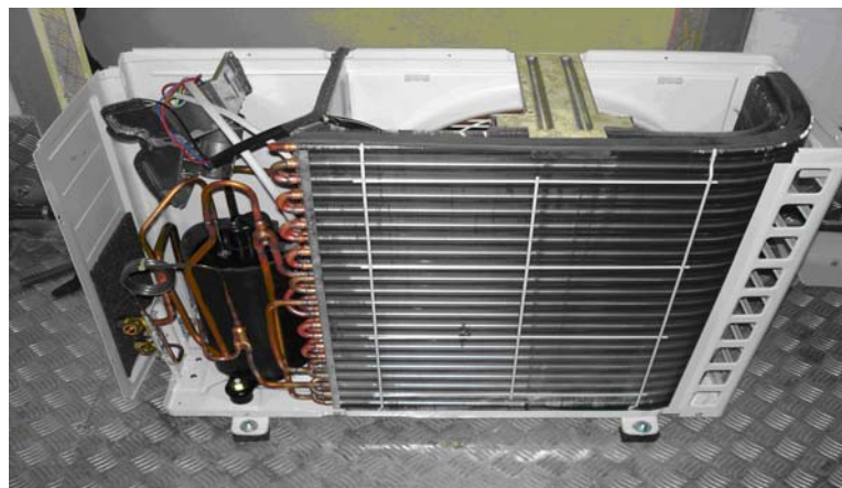
ภาพประกอบ 8 ชุดคอนเดนเซอร์ก่อนการปรับปรุง
