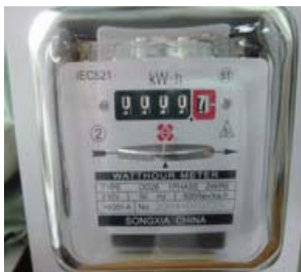
ภาพประกอบ 12 เครื่องมือวัดกำลังไฟฟ้า (kW-hr)
