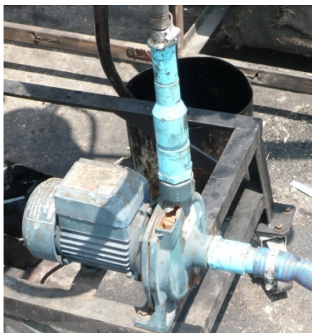
รูปที่ 4.13 ชุดปั๊มน้ำใช้ในระบบทำความสะอาดแก๊ส หอความแน่น
