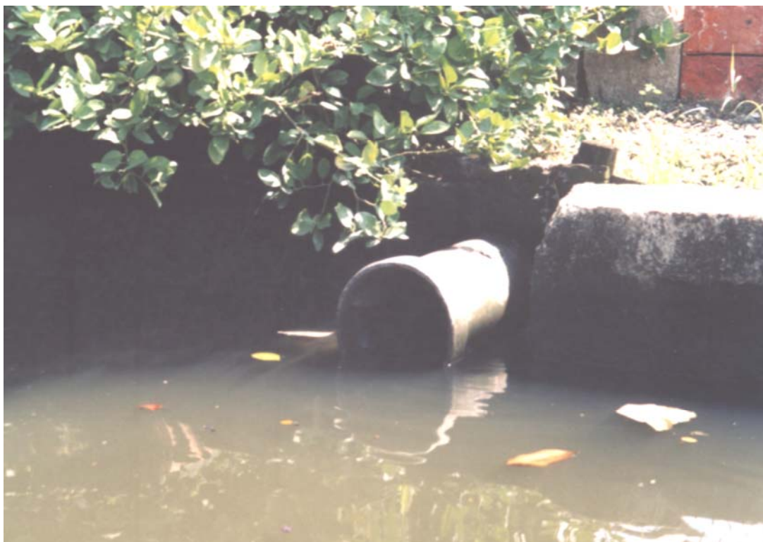
ท่อน้ำทิ้งจากแหล่งที่อยู่อาศัยริมคลองภาษีเจริญ
