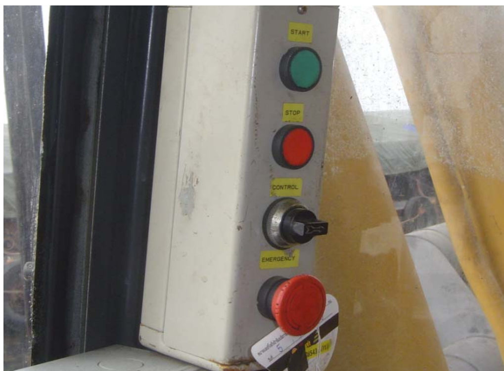
ภาพประกอบ 38 แสดงการติดตั้ง On/Off Switch-Emergency Switch ในห้องOperator
