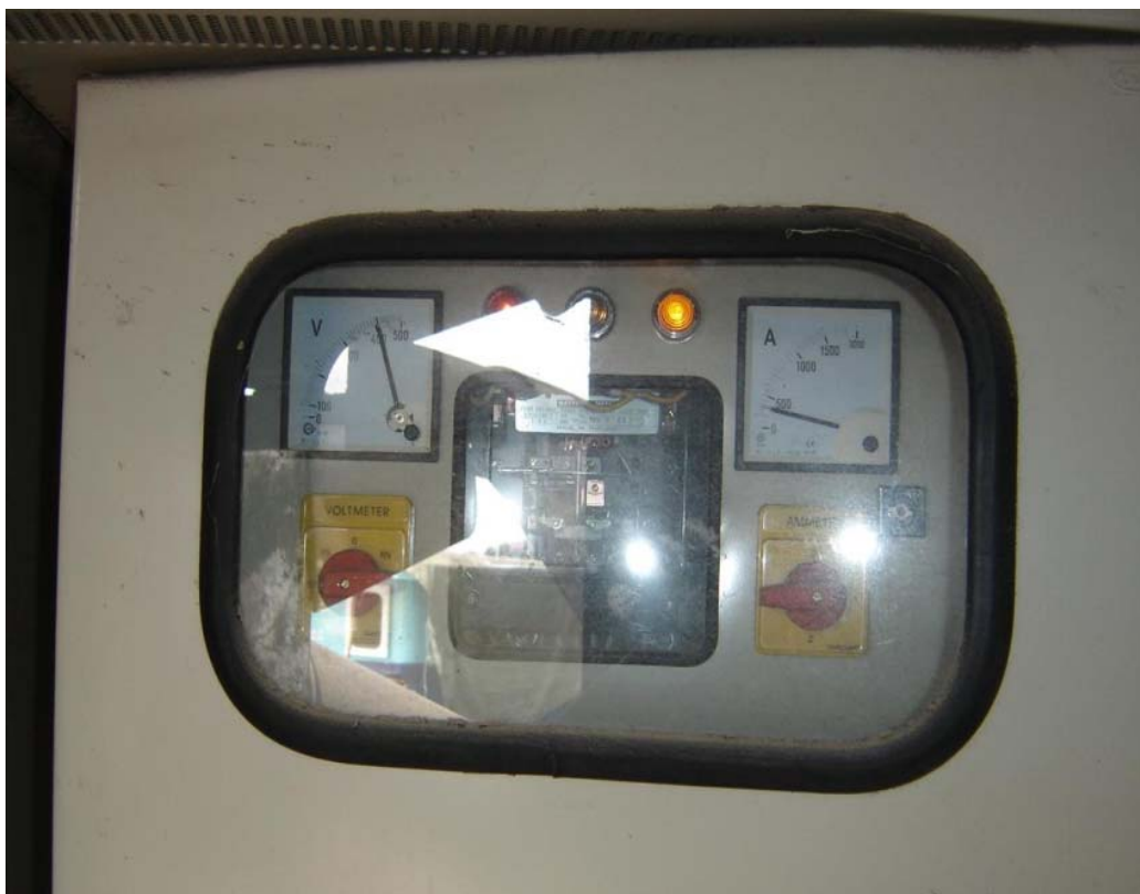
ภาพประกอบ 36 แสดงห้องจ่ายกระแสไฟฟ้า Substation 380V / 400A
