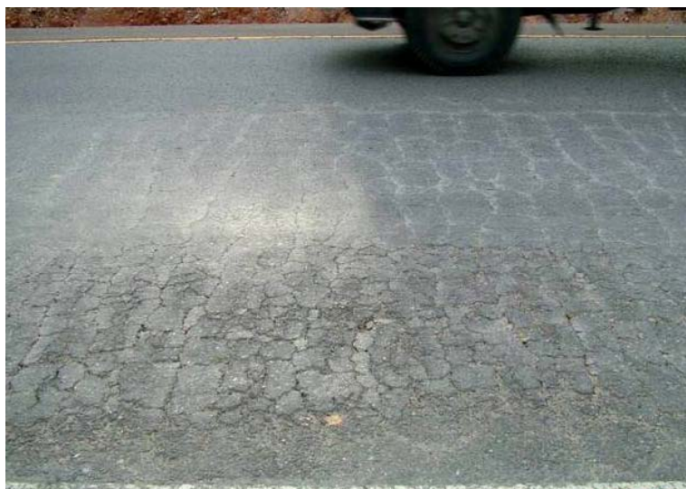
ภาพประกอบ 10 รอยแตกแบบหนังจระเข้ (Alligator Crack)
