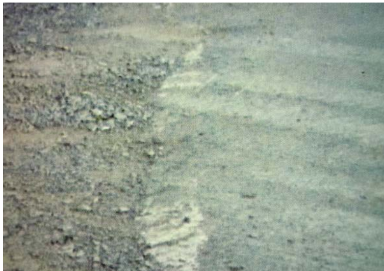
ภาพประกอบ 31 ความเสียหายตามขอบ (Edge Deterioration)
