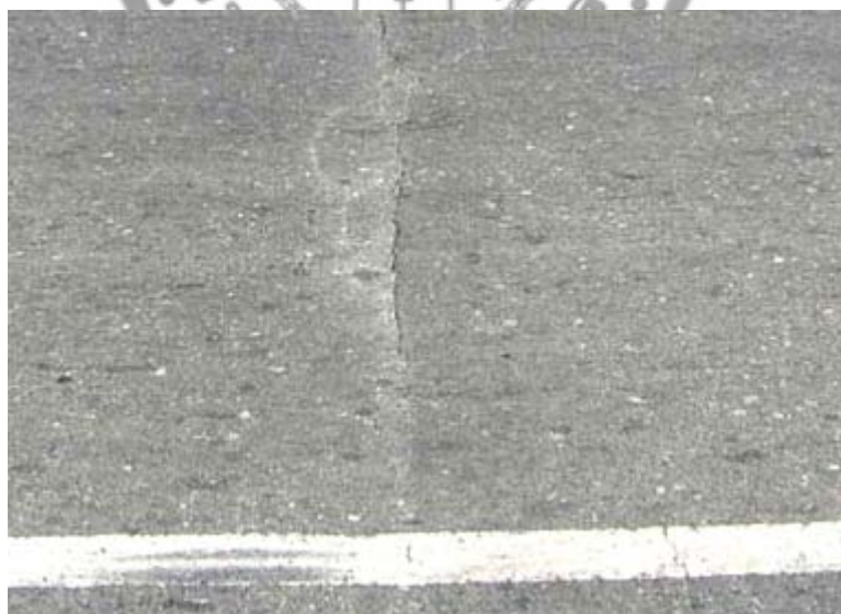
ภาพประกอบ 19 รอยแตกตามขวาง (Transverse Crack)
