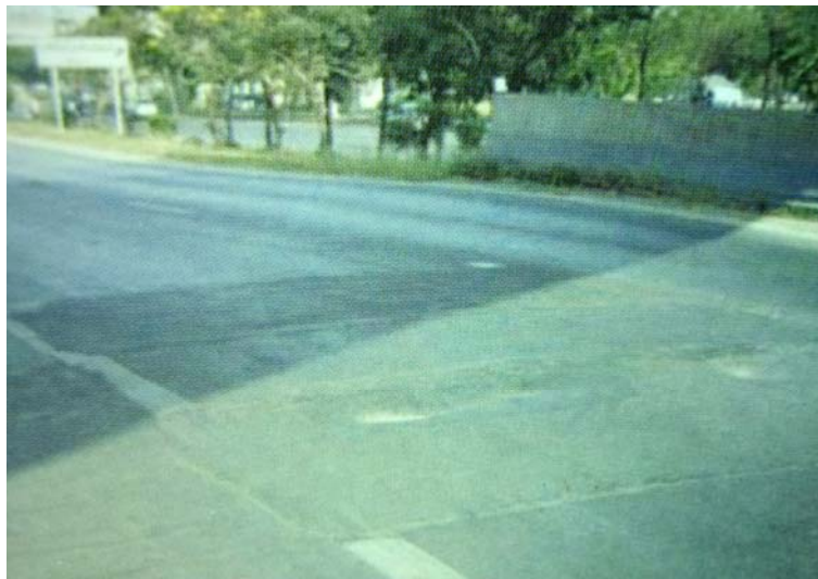
ภาพประกอบ 25 การทรุดตัวขุดฝังสาธารณูปโภค (Utility Cut Depression)
