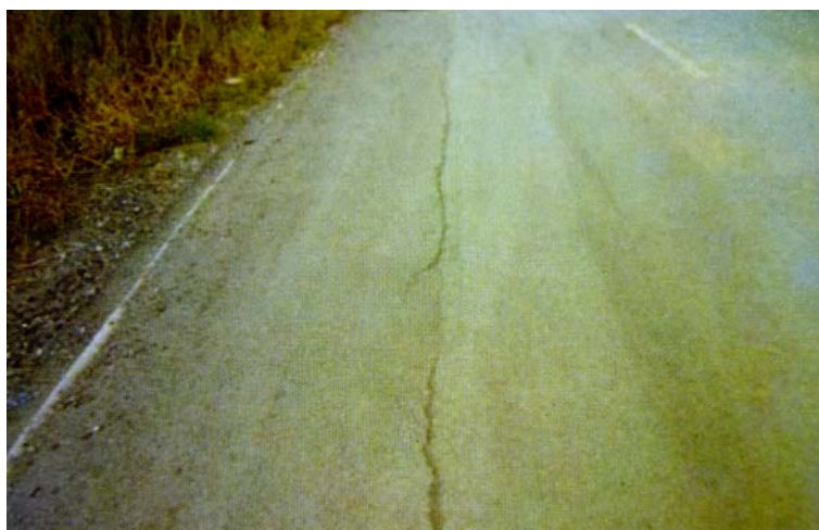
ภาพประกอบ 17 รอยแตกการขยายช่องจราจร (Widening Crack)
