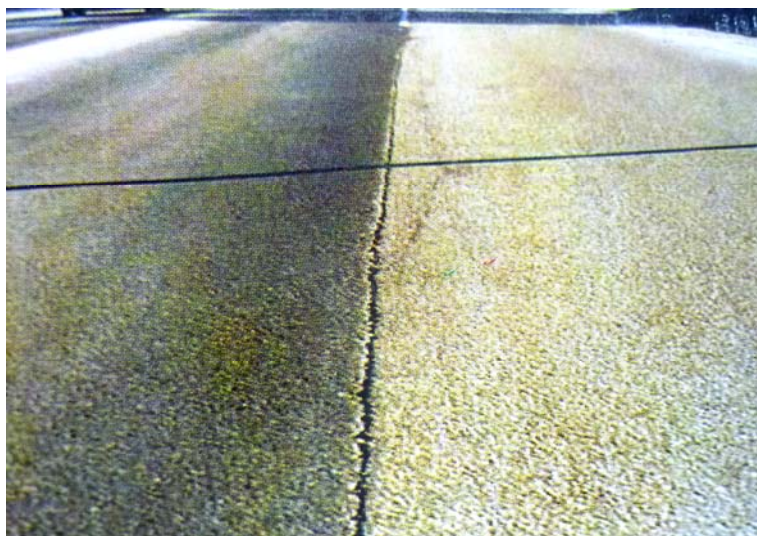
ภาพประกอบ 16 รอยแตกระหว่างช่องจราจร (Lane Joint Crack)
