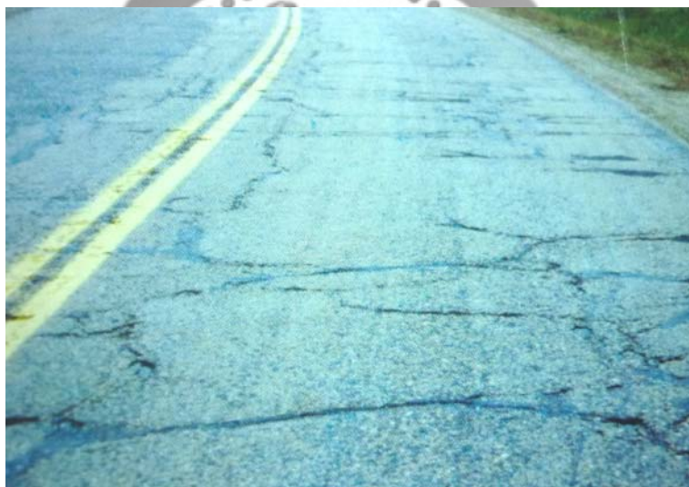
ภาพประกอบ 13 รอยแตกเป็นตาราง (Block Crack)
