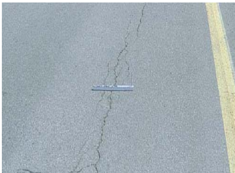
ภาพประกอบ 18 รอยแตกตามยาว (Longitudinal Crack)
