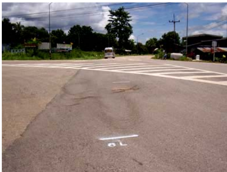
ภาพประกอบ 14 รอยแตกเลื่อนไถล (Slippage Crack)
