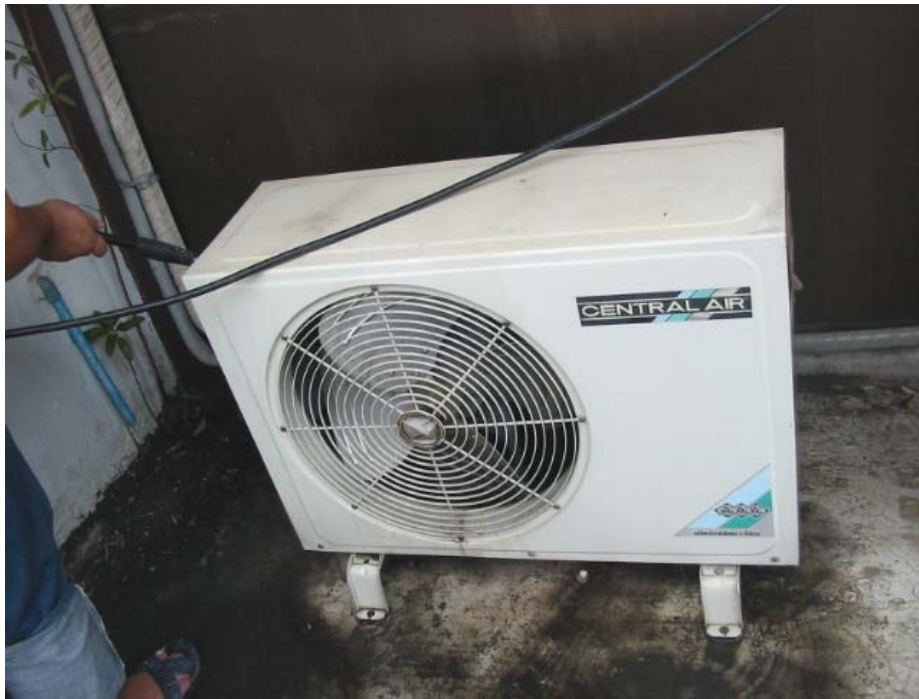
ภาพประกอบ 46 เครื่องปรับอากาศ (ชุดคอนเดนซิ่ง)
