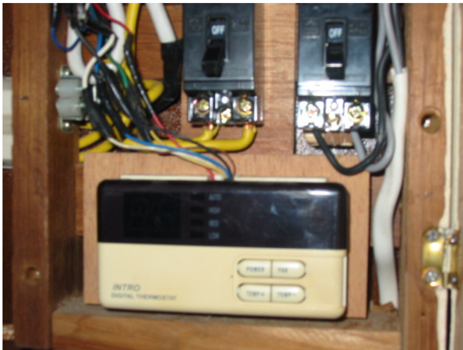
ภาพประกอบ 47 เครื่องปรับอากาศ (สวิตช์ควบคุมอุณหภูมิ และ ปิด-เปิด)
