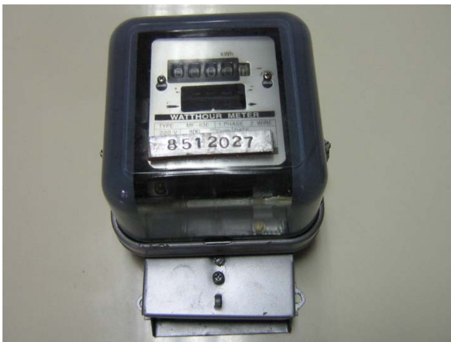
ภาพประกอบ 59 เครื่องวัดกำลังไฟฟ้า กิโลวัตต์เออาร์มิเตอร์ ยี่ห้อ Mitsubishi รุ่น MF-63 E
