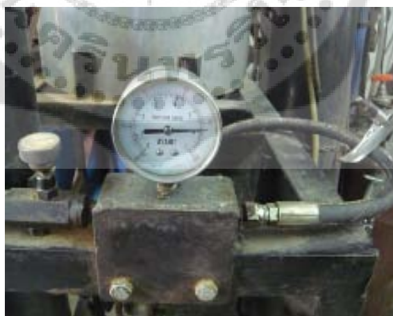
รูปที่ 3.8 เกจวัดแรงดันของระบบ
