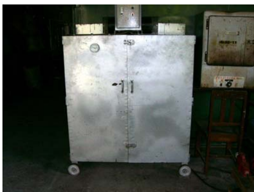
ตู้ไฟฟ้าควบคุมความชื้น
