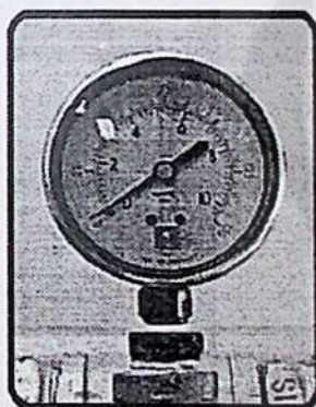
4. เกจวัดความดัน สำหรับอ่านค่าความดันที่ด้านดูด และด้านจ่าย
