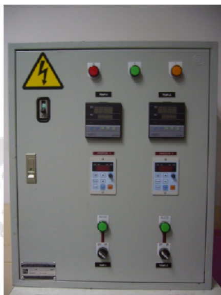
ภาพประกอบ 11 Electrical Control Switch
