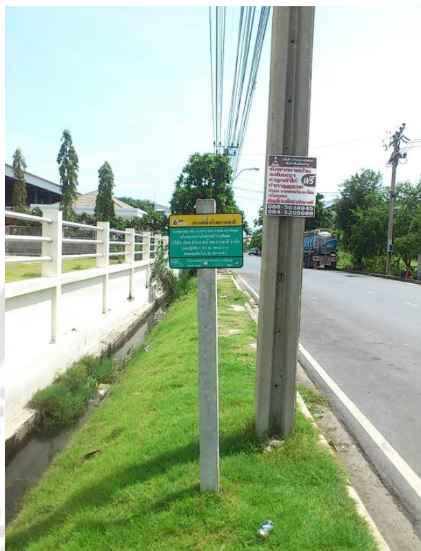
ภาพประกอบ 14 แนวท่อก๊าซธรรมชาติภายในนิคม
