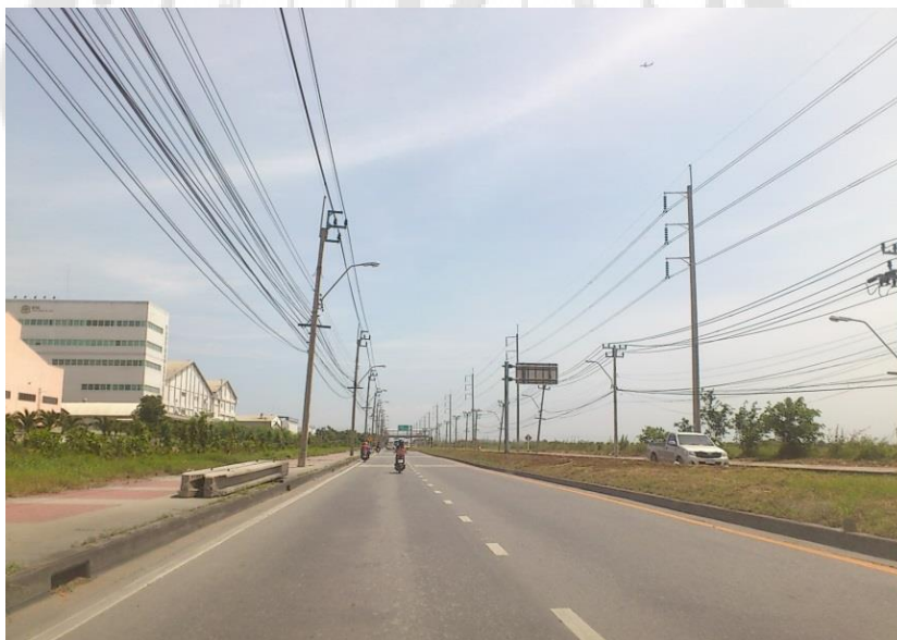
ภาพประกอบ 13 แนวสายไฟฟ้าระดับแรงดัน 24 kV และแรงดัน 115 kV ภายในนิคม
