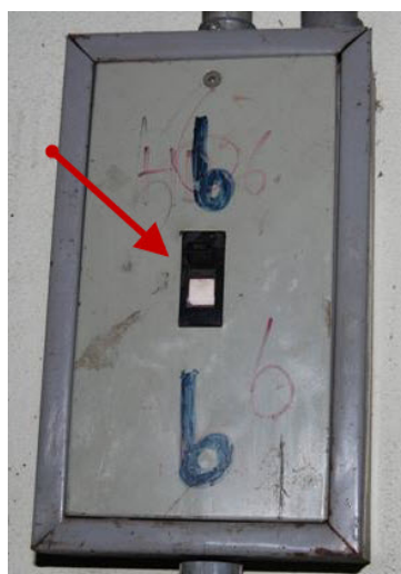
ภาพประกอบ 45 เบรกเกอร์ควบคุมไฟฟ้าหลัก
