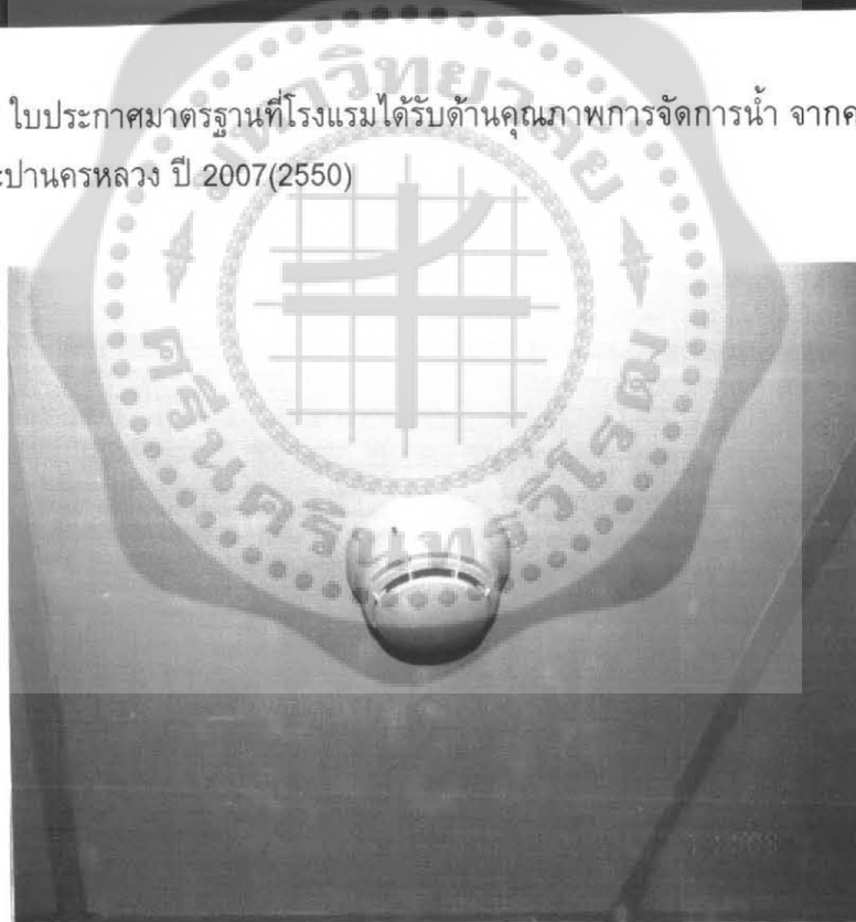
ภาพประกอบ 38 อุปกรณ์เตือนภัย เมื่อเกิดควันไฟ ติดตั้งบนเพดานห้องพักและห้องอื่นๆ ภายใน โรงแรม
