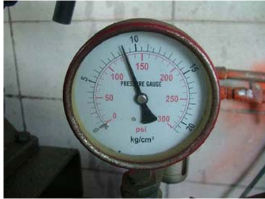
ภาพก่อนปรับปรุงแรงดันอากาศอัด
