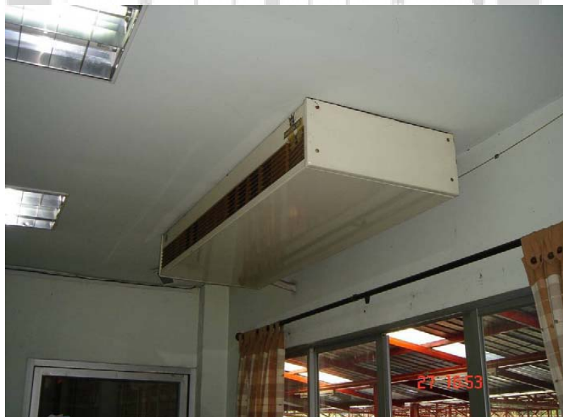
ภาพประกอบ 50 ภาพแสดงเครื่องปรับอากาศในสำนักงาน
