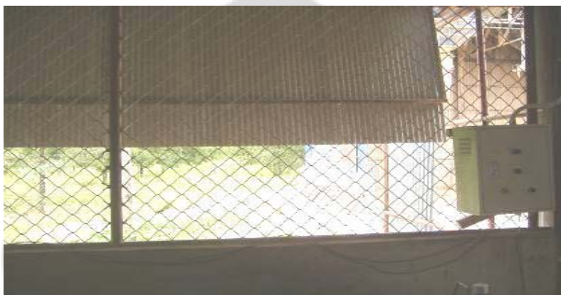
ภาพช่องระบายอากาศที่ใช้ระบายความร้อน
