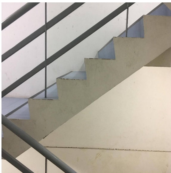
รูปที่ 4.12 บันไดหนีไฟของอาคาร
