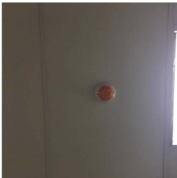
รูปที่ 4.7 อุปกรณ์ตรวจจับควัน
