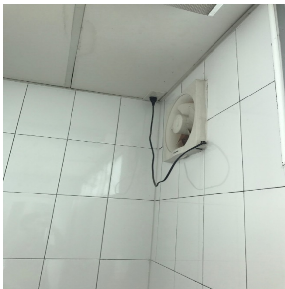
รูปที่ 4.22 พัดลมระบายอากาศภายในห้องน้ำของอาคาร
