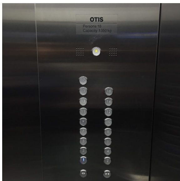
รูปที่ 4.29 ปุ่มกดภายในลิฟต์ (2)
