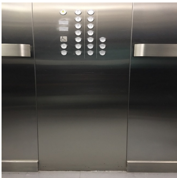
รูปที่ 4.34 ปุ่มกดภายในลิฟต์ผู้พิการ
