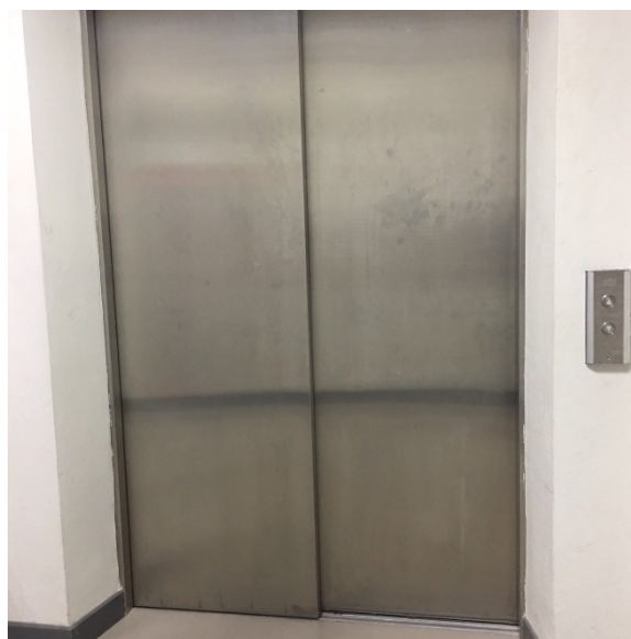
รูปที่ 4.2 ลิฟต์ดับเพลิง
