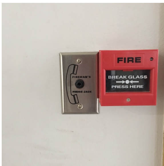
รูปที่ 4.4 ระบบแจ้งเหตุที่ใช้มือ
