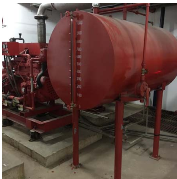
รูปที่ 4.6 ระบบเก็บสำรองสำหรับดับเพลิง
