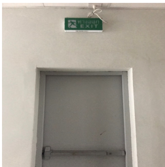
รูปที่ 4.9 ประตูหนีไฟของอาคาร
