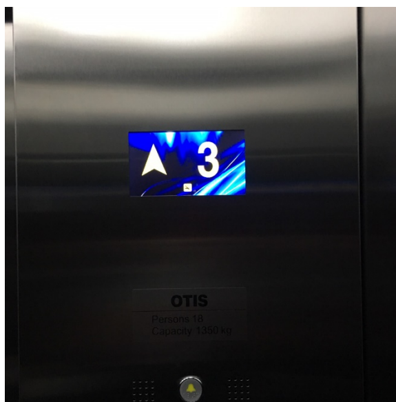
รูปที่ 4.30 ไฟแสดงชั้นภายในลิฟต์
