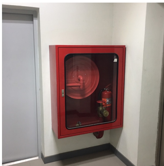
รูปที่ 4.1 ตู้หัวฉีดน้ำดับเพลิง
