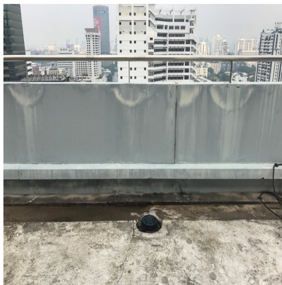
รูปที่ 4.20 ท่อระบายน้ำฝน
