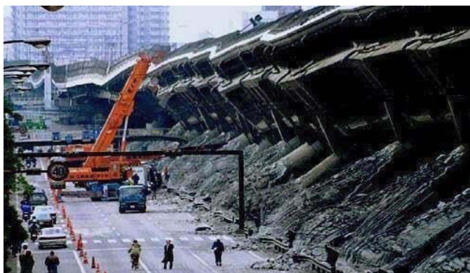
รูปที่ 2.3 ความเสียหายที่เกิดขึ้นเนื่องจากแรงแผ่นดินไหว
