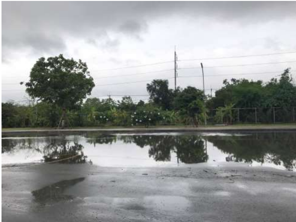
รูปที่ 4.28 บริเวณที่เกิดน้ำท่วมขังบนถนน
