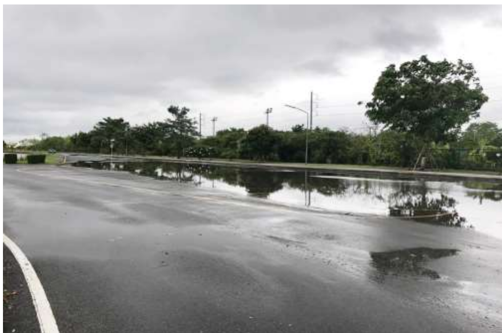
รูปที่ 4.25 บริเวณที่เกิดน้ำท่วมขังบนถนน
