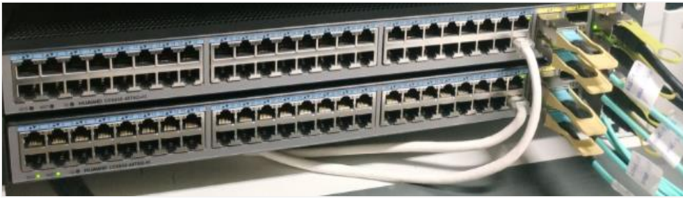
อุปกรณ์กระจายสัญญาณ (Switch) แบบ datacenter จำนวน 2 เครื่อง
