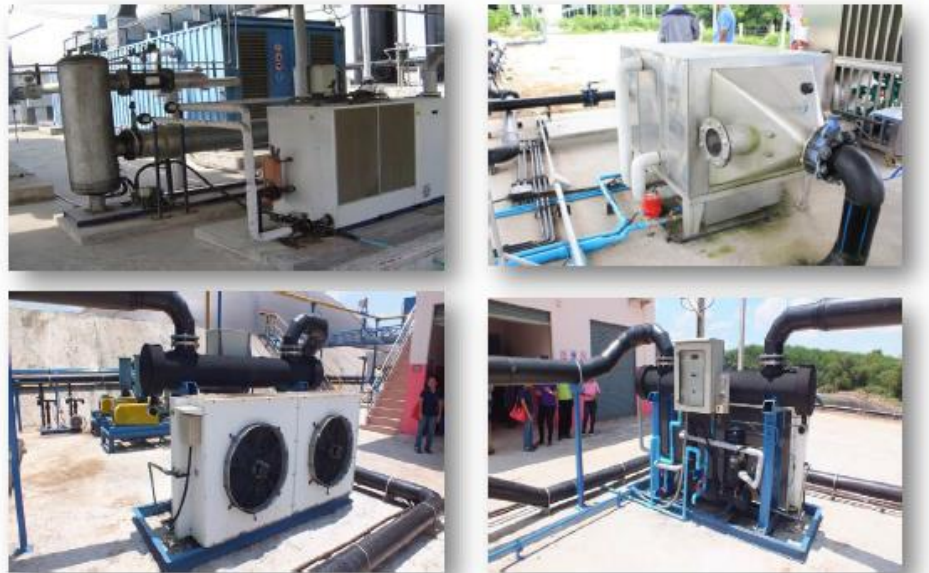
รูปที่ ก-19 ระบบ Refrigeration การแลกเปลี่ยนความร้อนระหว่างก๊าซชีวภาพกับสารทำความเย็น
