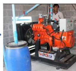
ถังเก็บก๊าซชีวภาพ+เครื่องกำเนิดไฟฟ้า
