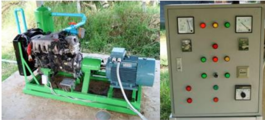
รูปที่ 2.20 เครื่องยนต์เบนซินตัดแปลง (ใช้ก๊าซชีวภาพ 100%) และตู้ควบคุมการทำงาน
