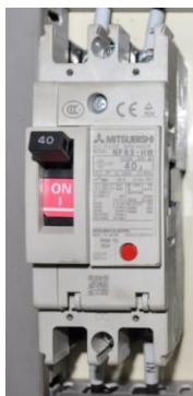
ภาพประกอบ 36 เซอร์กิตเบรกเกอร์ ยี่ห้อ Mitsubishi รุ่น NF63-HW 2P 40A, 220V
