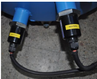
(ก) ฝาครอบจุดต่อสายไฟ
