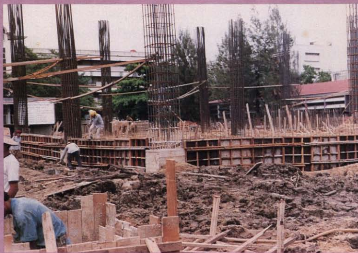
อาคารสมเด็จพระเทพรัตนราชสุดาฯ ระหว่างการก่อสร้าง
