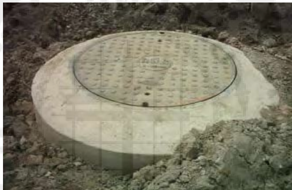
รูปที่ 2.41 Manhole and Handhold ที่มา : กองมาตรฐานระบบไฟฟ้า (ธันวาคม 2548)
