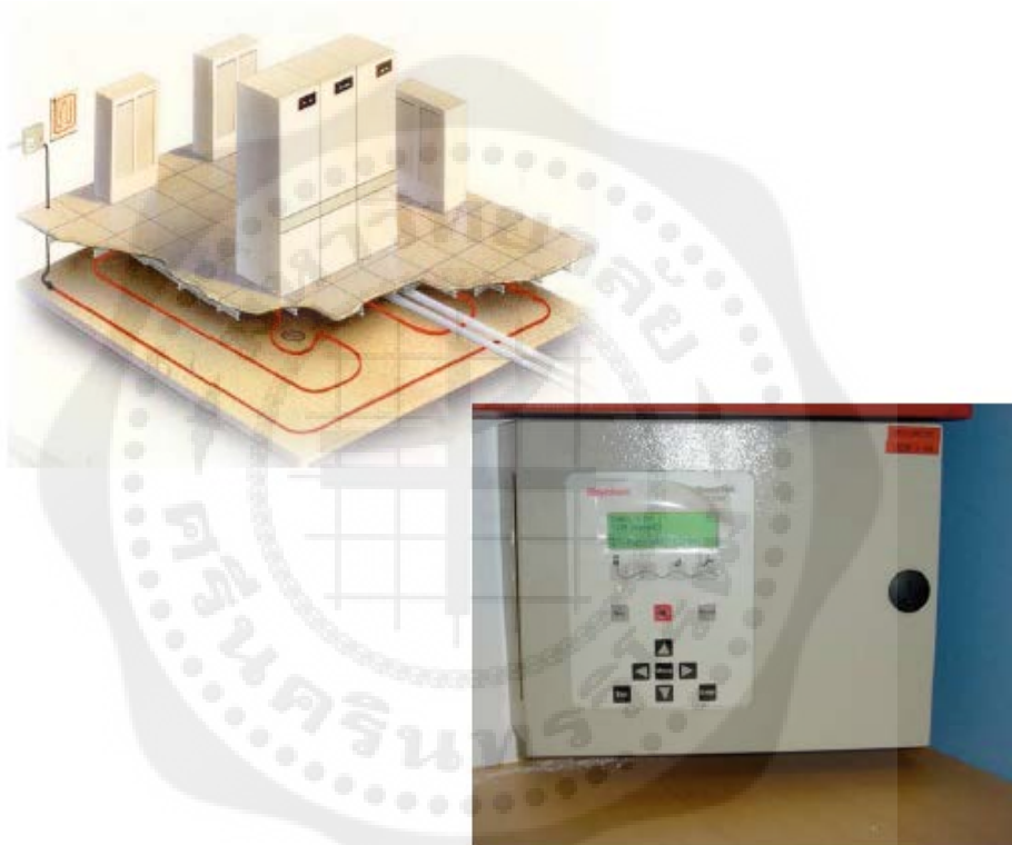
รูปที่ 2.50 แผงควบคุมอุปกรณ์ตรวจจับการรั่วซึมของน้ำใต้พื้นยกชนิดระบระยะได้
