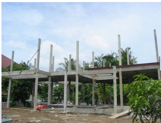
ภาพประกอบ 3 โครงสร้างเสาและคานสำเร็จรูป ที่มา : บริษัทแลนต์โฮม (ประเทศไทย) จำกัด.
