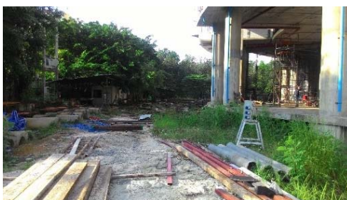
รูปที่ 4.3.5 เศษเหล็กที่เคลื่อนกลาดบริเวณพื้นที่ทำงาน
