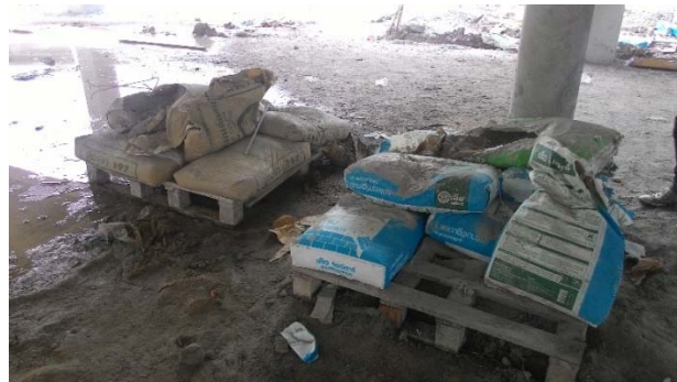
รูปที่ 4.3.7 ปูนก่อฉาบที่ถูกแกะทิ้งไว้
