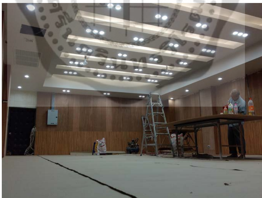
ภาพประกอบ 138 แสดงการติดตั้งผนังห้องเรียนต้นแบบ
