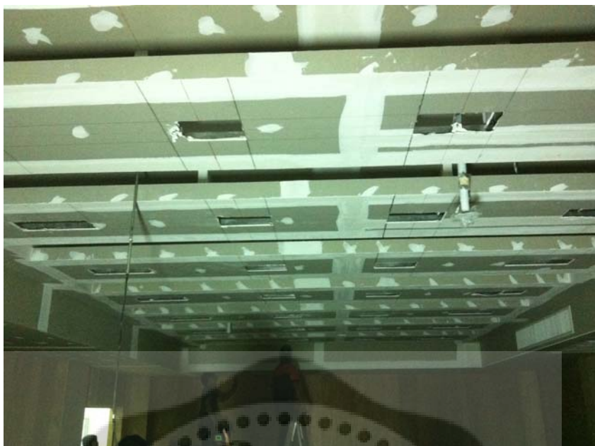
ภาพประกอบ 107 แสดงการติดตั้งระบบไฟแสงสว่างบนฝ้าเพดานทั้งไฟส่องสว่างแบบ Uplight และ Downlight
