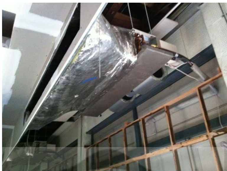
ภาพประกอบ 101 แสดงส่วนทำความเย็นของระบบปรับอากาศภายในห้องเรียนที่ยึดติดแขวนกับฝ้าเพดานของห้องเรียนต้นแบบ
