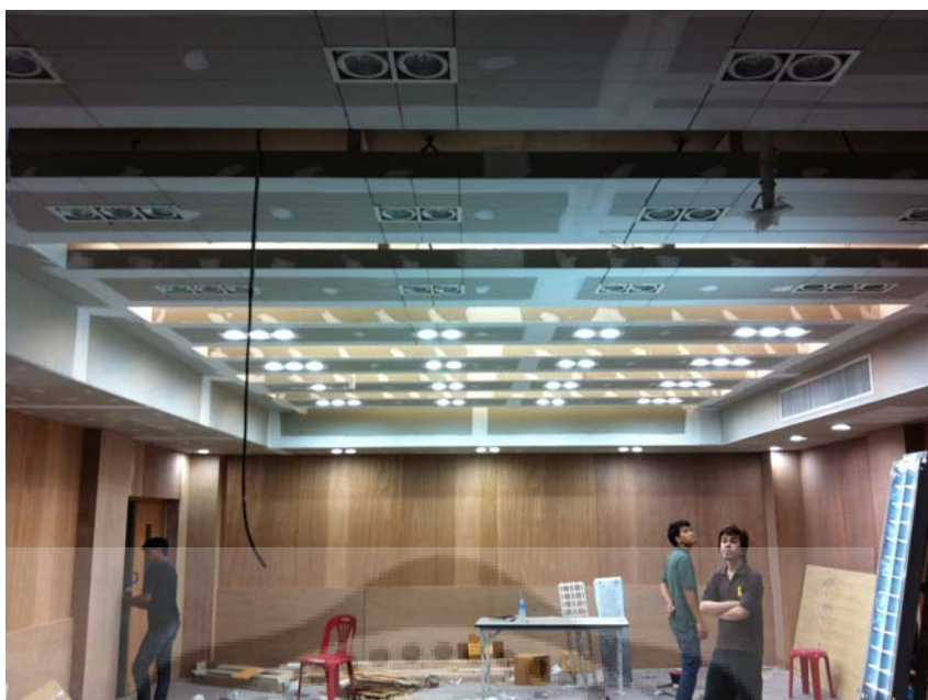
ภาพประกอบ 113 แสดงการทดสอบเปิดระบบไฟแสงสว่างภายในห้องเรียนทั้งแบบ Up light และ Down light โคมไฟแสงสว่างบนฝ้าเพดานของห้องเรียนต้นแบบ
