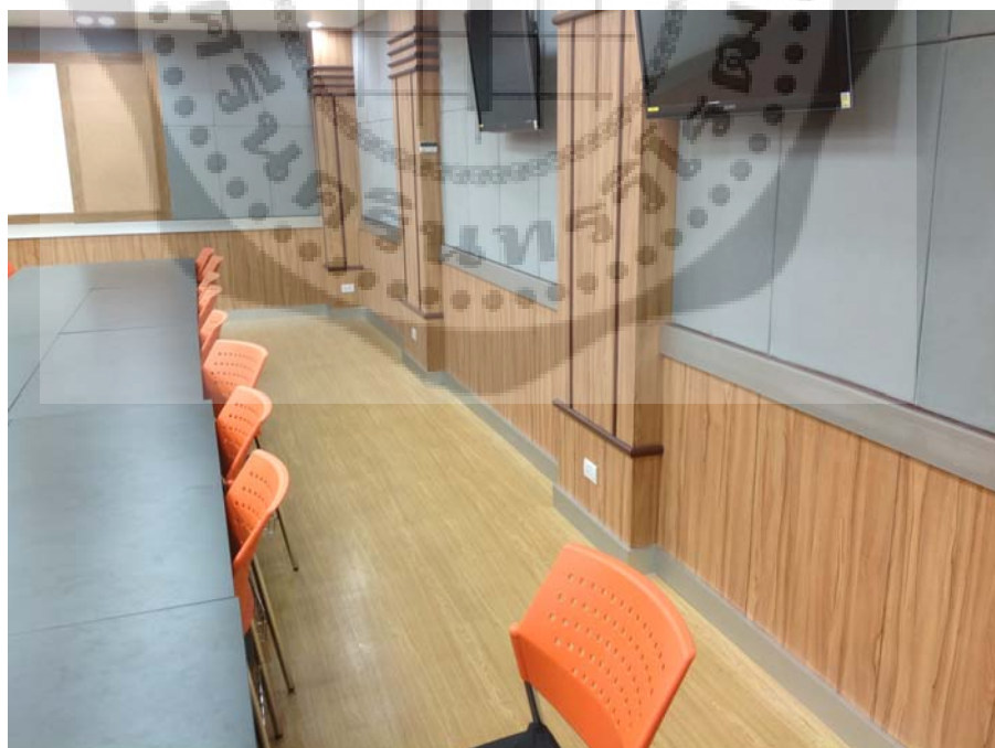
ภาพประกอบ 118 แสดงตำแหน่งของปลั๊กไฟที่ผนังห้องเรียนฝั่งขวาของห้องเรียนต้นแบบ
