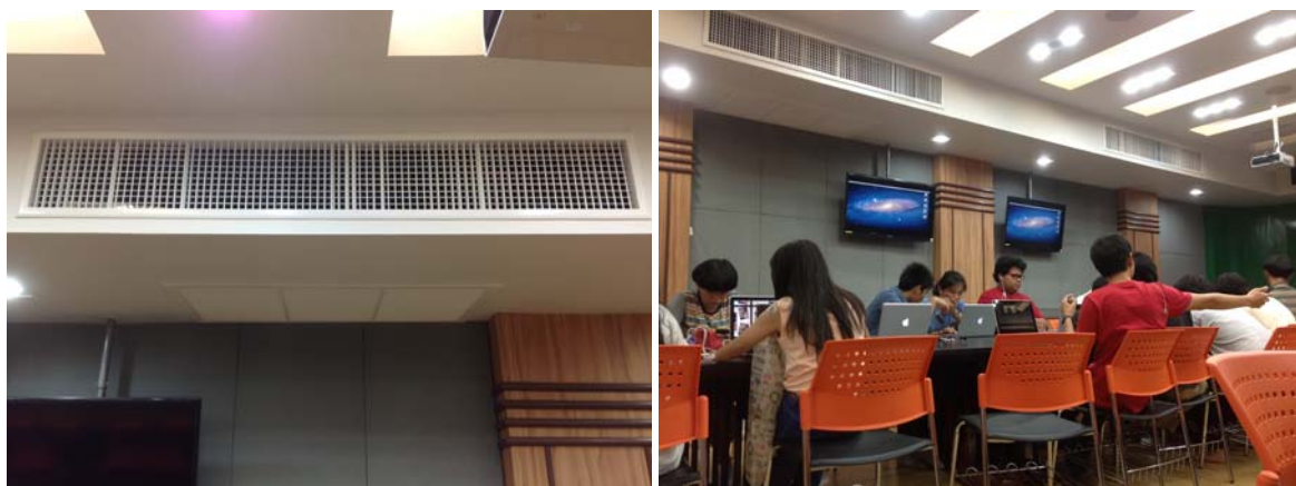
ภาพประกอบ 52 แสดงตำแหน่งการติดตั้งของเครื่องปรับอากาศในห้องเรียนต้นแบบ
