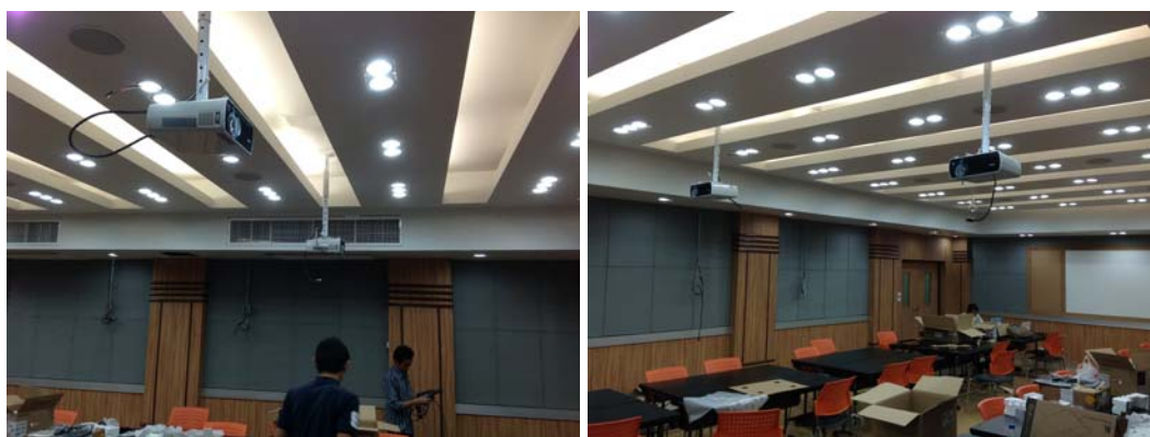
ภาพประกอบ 21 แสดงการติดตั้งเครื่องฉายภาพ LCD Projector
