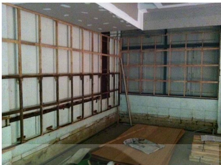
ภาพประกอบ 95 แสดงโครงคร่าวไม้บริเวณผนังด้านหน้าของห้องเรียนต้นแบบ
