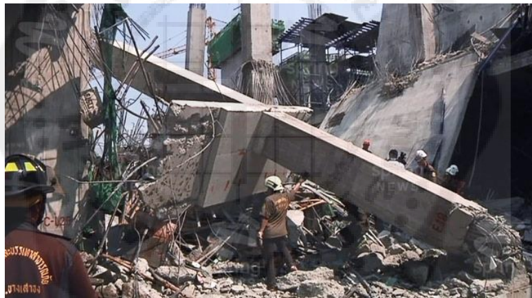
รูปที่ 1.1 อาคาร U Place Condotel ที่ถล่มลงมาขณะยังก่อสร้างไม่เสร็จ
